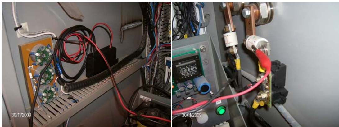
Figura 3 - Izq. Amplificador aislado de tensión de cuba en gabinete - ubicación provisoria y (der.) conexión sensor Allegro 100A mas tomas de tensión de cuba.
